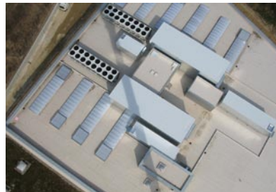
Ein Blick auf das Dach des Gebäudes 24a zeigt die fünf Lüftungszentralen und die Rückkühler.
