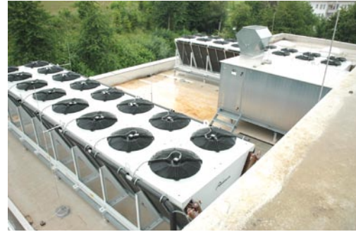
Bei Außentemperaturen unter 7°C wird die Kälteleistung von den am Dach installierten Rückkühlern erbracht.
