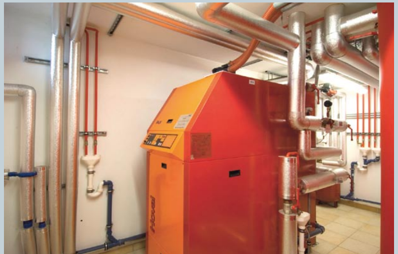
Neben der Straka-Niederlassung Laa an der Thaya wird durch den Pelletskessel Hoval BioLyt (70 kW Heizleistung) auch noch ein zweites Gebäude beheizt.
