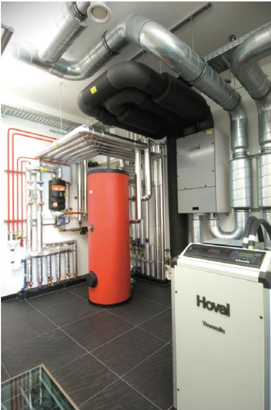
Die Heizungsanlage der Straka-Niederlassung Laa an der Thaya dient zugleich als Schaumraum für Kunden.
